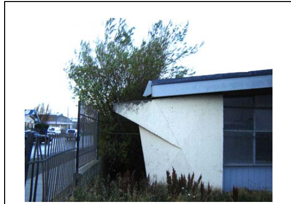
Fig. 3. Machón poligonal de hormigón armado. Foto de Max Aguirre, mayo de 2007.
